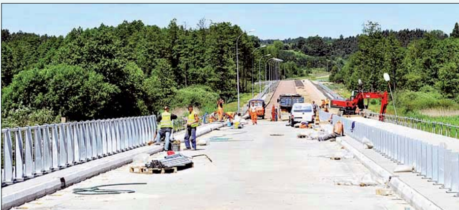
Budowa trasy przemysłowej południowo-zachodniej przebiega sprawnie i dobiega końca. Oddanie jej do użytku ma nastąpić w sierpniu br.
